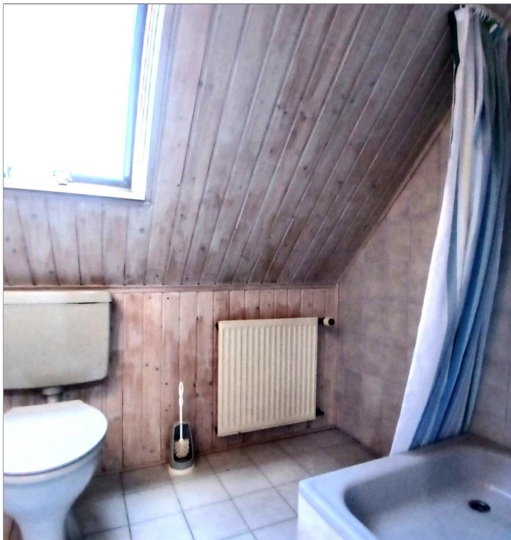
Duschbad - DG (Bild 2)
